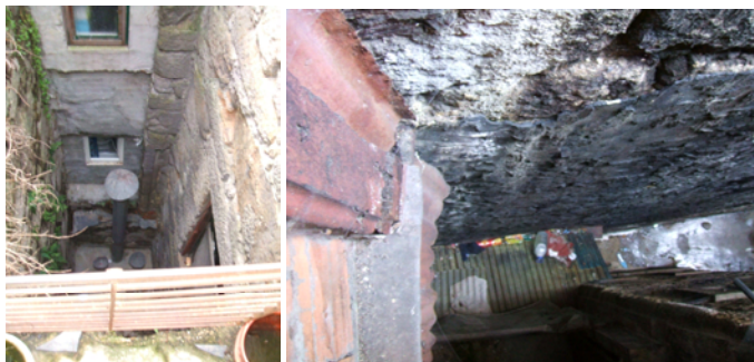
Saguões em edifícios em mau estado de conservação
