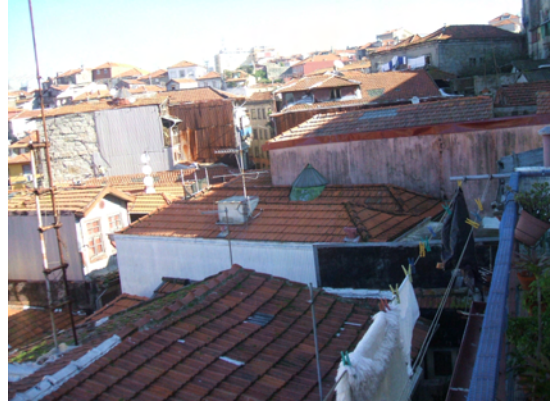
Vista da fachada tardoza de um edifício da Rua de Pena Ventosa, sobre os telhados dos edifícios voltados à Rua da Bainharia
