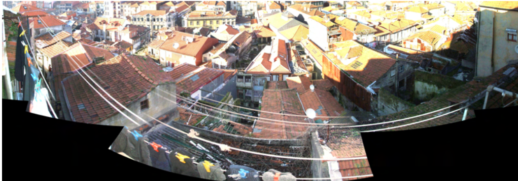
Vista panorâmica do sector central do quarteirão, prédios em ruína volvidos à Rua da Bainharia (parcelas 10,13 e 14)
