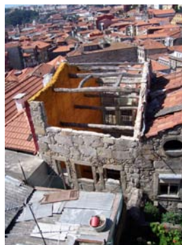
P 011_estado de ruína
