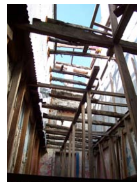
P 004_estado de ruína
